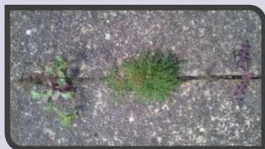
► Végétation entre les joints
